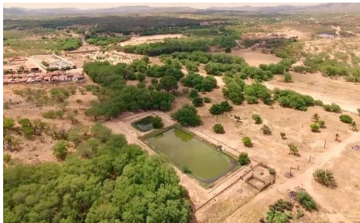
Figura 1. Estação de tratamento de esgoto de Frei Martinho/PB, composta por lagoas de estabilização.
