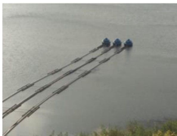
Figura 1 - Bombas de sucção flutuante localizados no açude Epitácio Pessoa, Boqueirão – PB.
